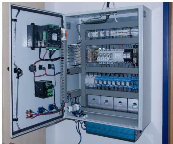
Obrázek 2 – Vnitřní část rozvaděče.
