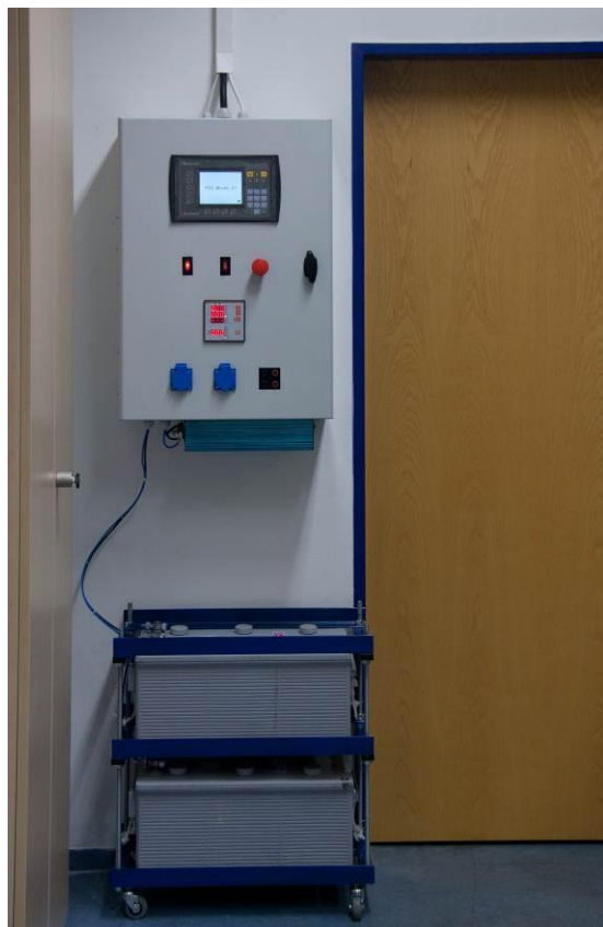
Obrázek 1 – Rozvaděčová skříň s řídicí jednotkou a bateriemi.
