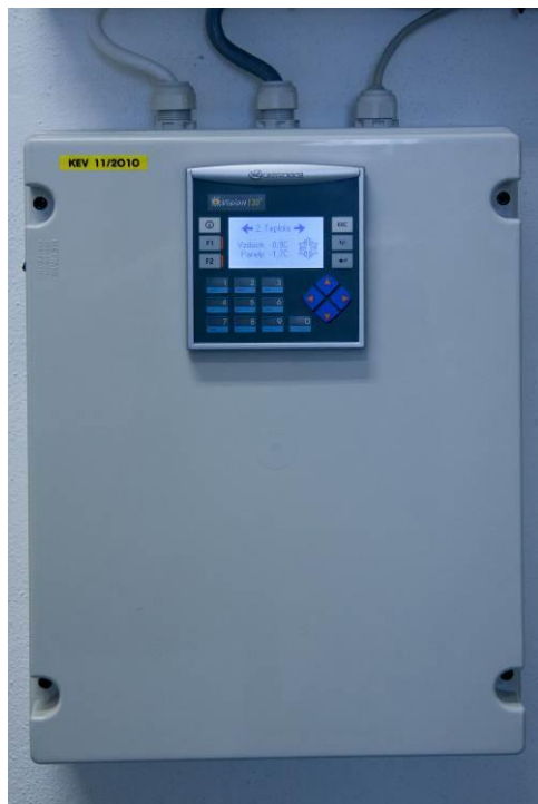
Obrázek 1 – Rozvaděčová skříň a řídicí jednotka
