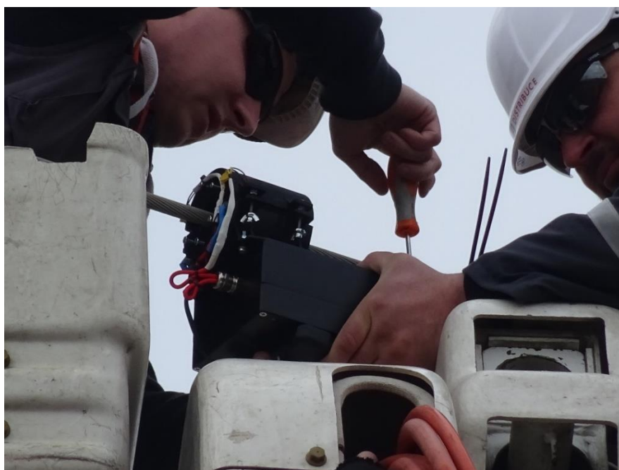
Obr. 8 Místo instalace měřicí platformy na 22kV vedení u obce Křimice - Detail montáže
