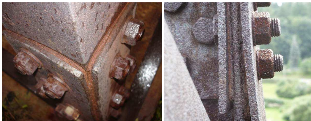
Obr. 2: Příklad koroze v místě šroubového spoje. [10]
