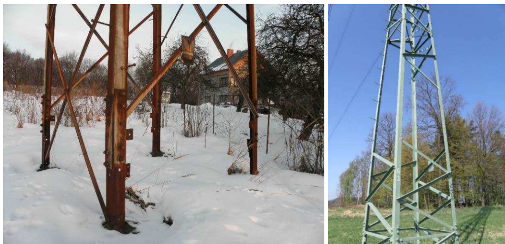
Obr. 1: Odcizení příček stožáru. [10]
