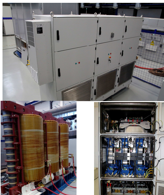
Obr. 1 Pilotní poloprovoz Zařízení pro kompenzaci zemních poruch
