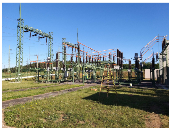
Obr. 3 Distribuční rozvodna vysokého napětí
