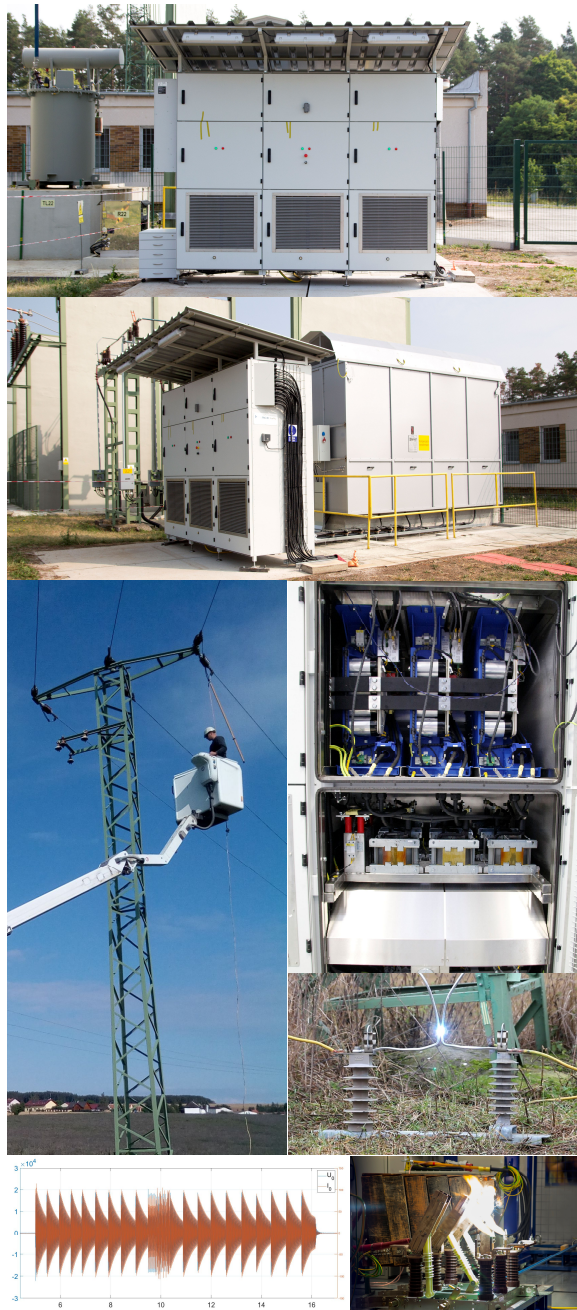
Obr. 1 Zařízení pro kompenzaci v distribuční síti 22 kV během ročního pilotního provozu a řízených testů zemních poruch
