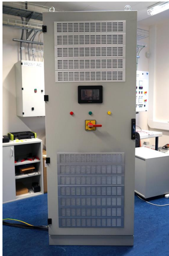
Obrázek 1 – Čelní pohled na rozvaděčovou skříň EESS
